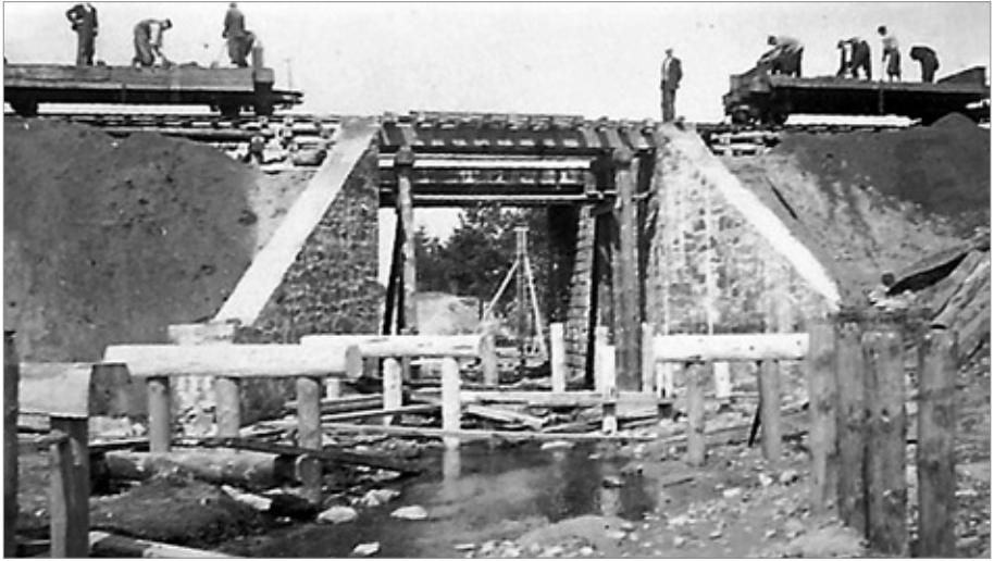
Prace przy budowie wiaduktu kolejowego oraz drewnianych estakad: wąskotorowej (z lewej) i drogowej (po prawej). Wierzbka, 1942 r. Ze zb. Witolda Bimera
